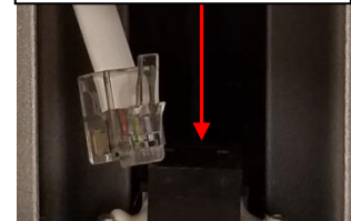
Cable de celda de carga no conectado
