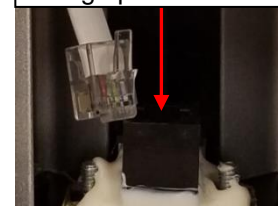
Câble de cellule de charge pas connecté
